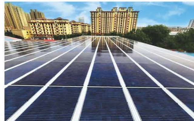
山东省潍坊市安丘市华安炉具场325KW项目
