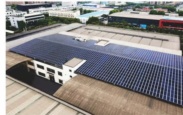
成都硅宝科技610kw项目
